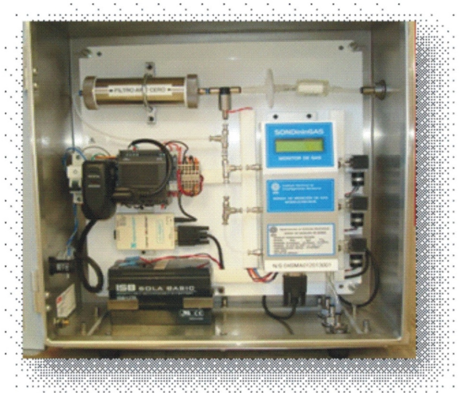
Componentes internos de la Estación Automática de Monitoreo (SONDininGAS, modelo SECN06)
